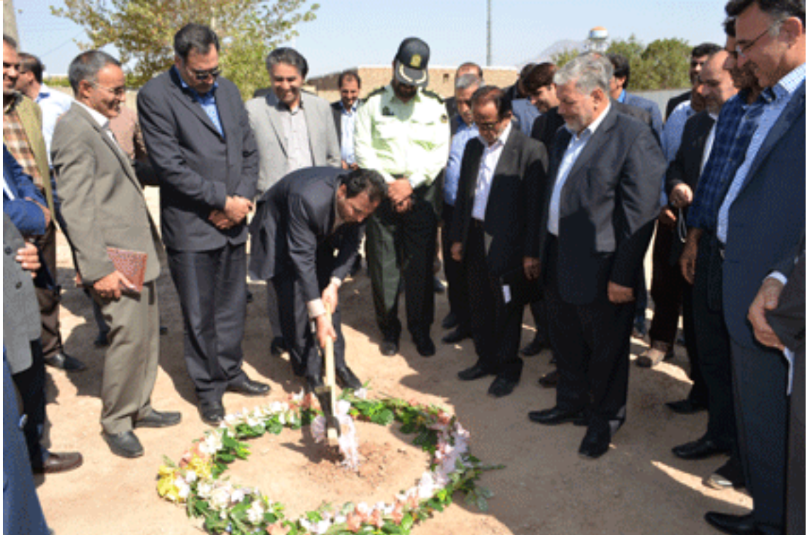
لازم به ذکر است مدرسه قبلی دکتر شریعتی با عمر بیش از 50 سال نیازمند تخریب و نوسازی بود که با سرمایه گذاری سازمان منطقه آزاد ارس یک مجموعه آموزشی با امکانات رفاهی و ورزشی در حال احداث می باشد.
